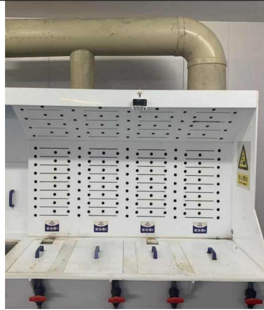
酸洗废气采用侧吸+顶吸集气罩收集
