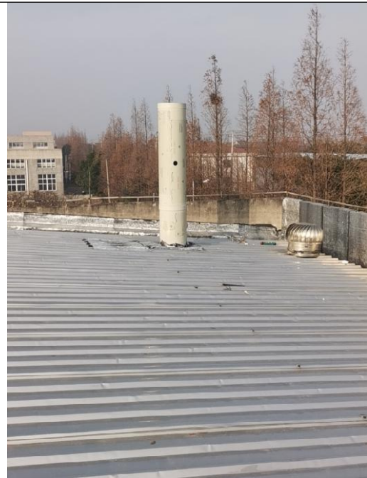
15米高 FQ-01 排气筒
