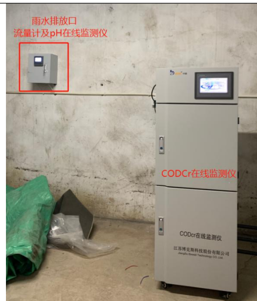
厂区雨水排放口流量计及 pH、 COD Cr 在线监测仪
