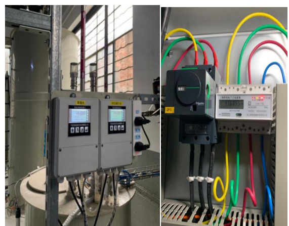
MVR 装置进水、出水流量计及独立电表
