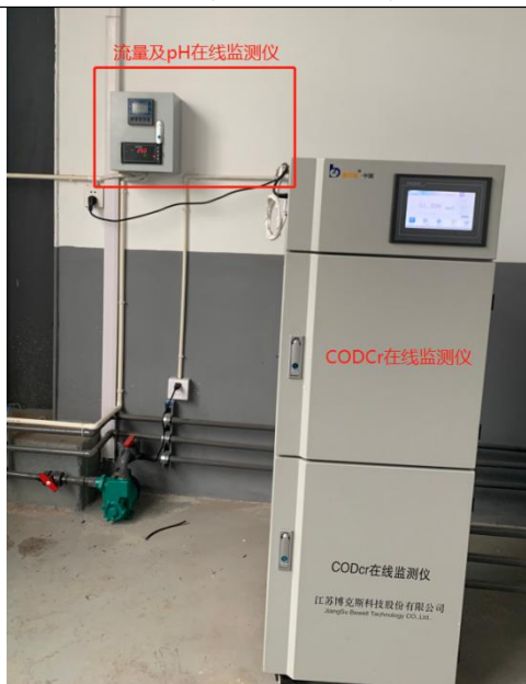
本项目所租车间污水接管口流量计、pH、 COD Cr 在线监测仪
