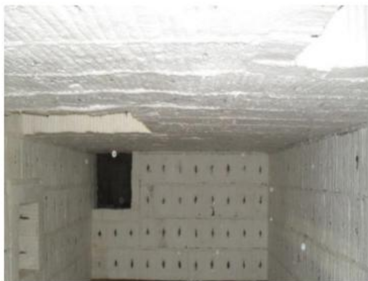
图 7-10 三床 RTO 氧化室
