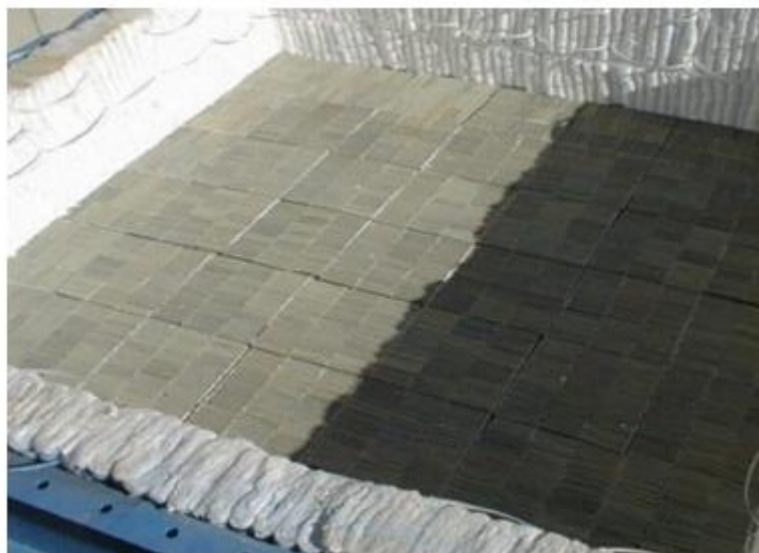
图 7-11 三床 RTO 蓄热室
