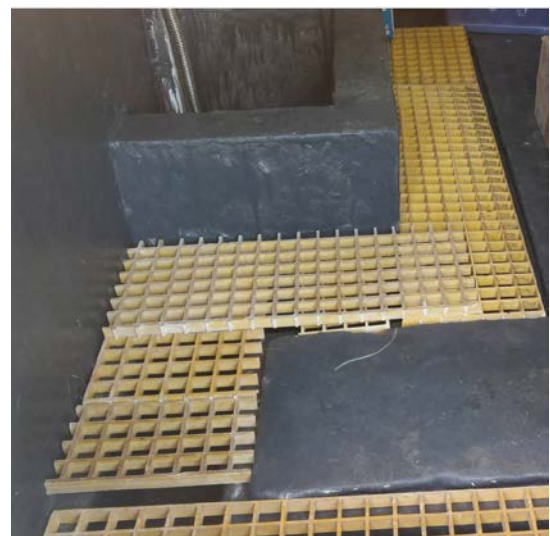
危废仓库内部导流沟槽：
