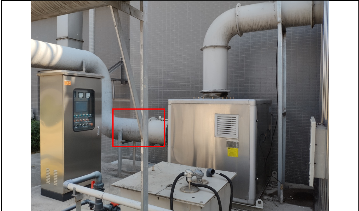
1#废气处理设施进口段管道长度不符合《固定源废气监测技术规范》中 5.1.2 节要求，不具备监测条件。
