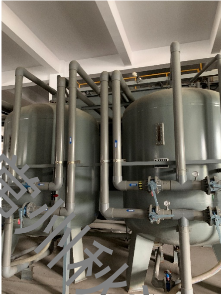
石英砂过滤器+活性炭过滤器：
