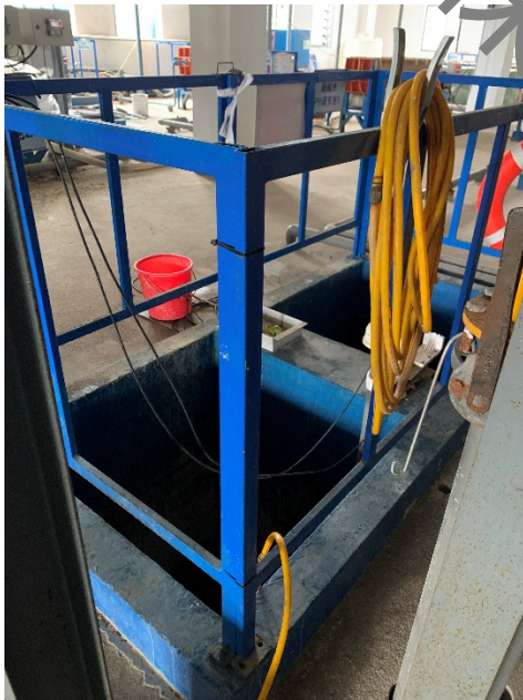
调节池+曝气中和池：
