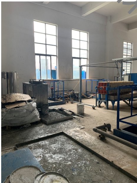
喷漆水帘废水及拖地废水处理系统整体
