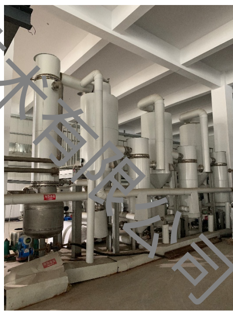
三效蒸发装置：
