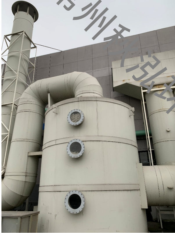
前处理废气处理设施（碱喷淋塔）：
